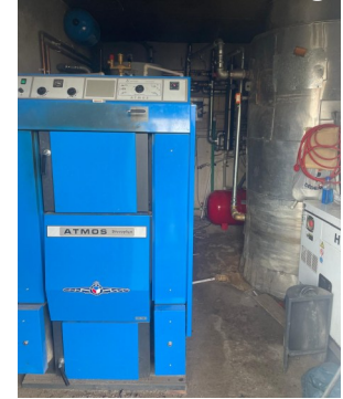
Die neue Zentralheizung
